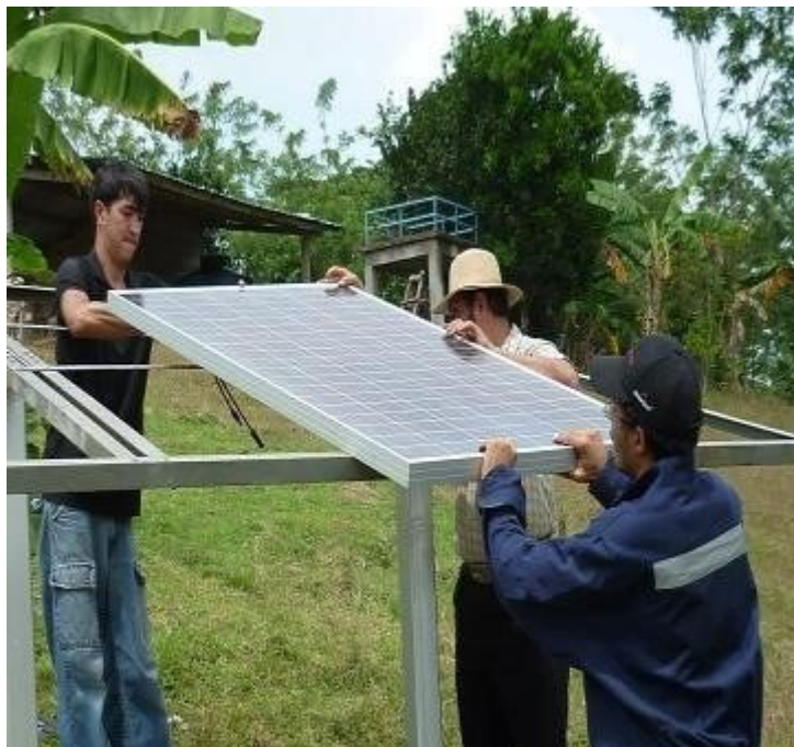
Figura 1 - Sistema de generación eléctrica instalado en la escuela
